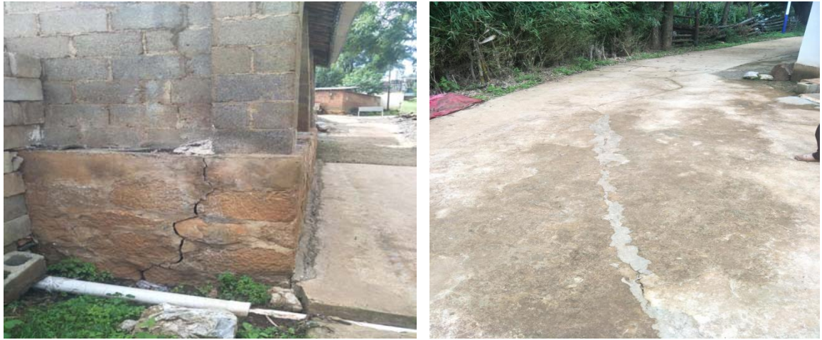
照片 5、6 滑坡后缘裂缝
